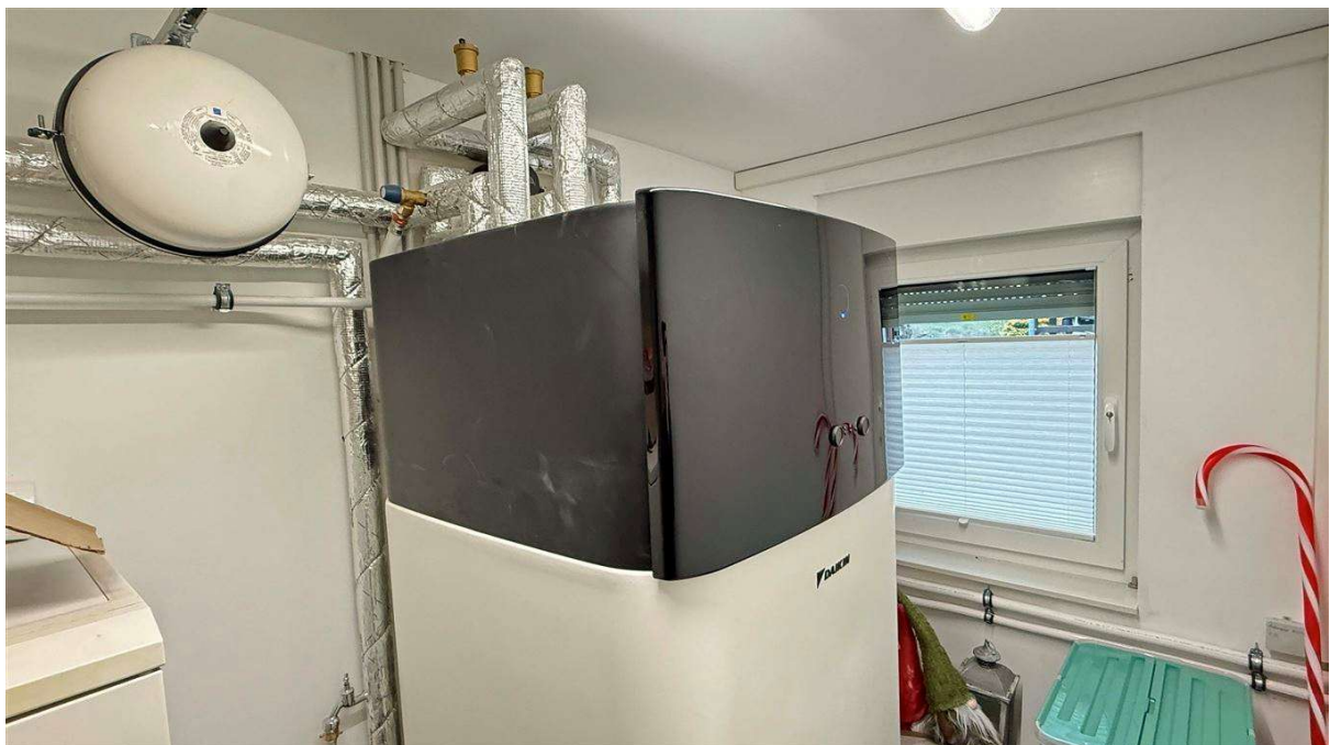
Heizung ELW: Wärmepumpe Baujahr 2022 als FB-Heizung
