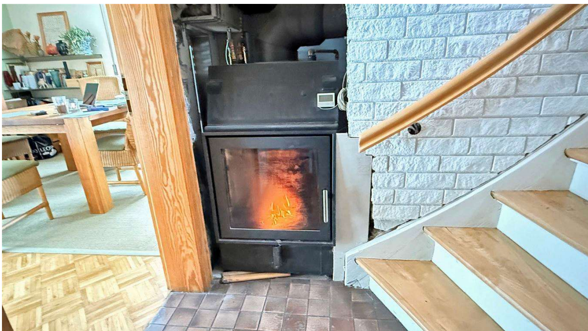
wasserführender Kaminofen als 2. Zentralheizung
